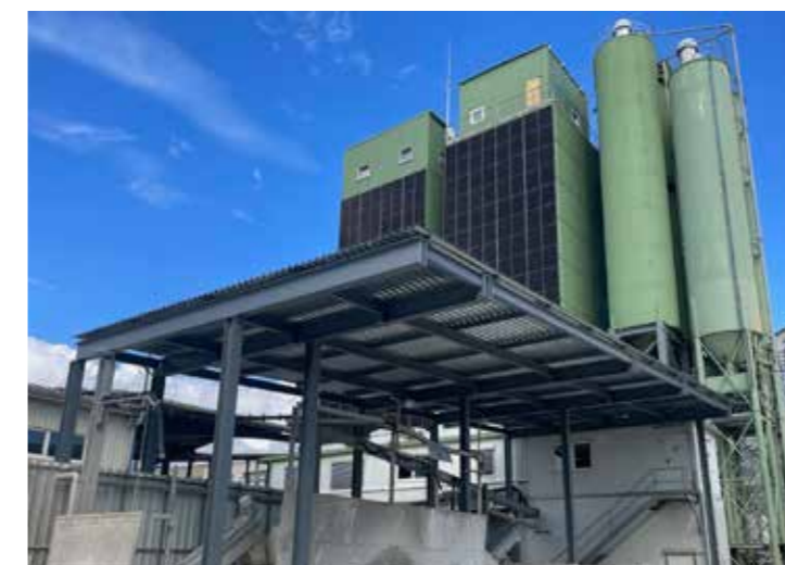
Panneaux photovoltaïques à la centrale de Marin.
